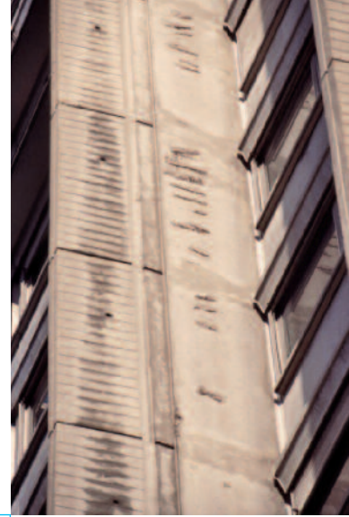
Corrosion de béton armé de pignons
