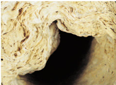
Engorgement de descente d'eau pluviale par des carbonates
