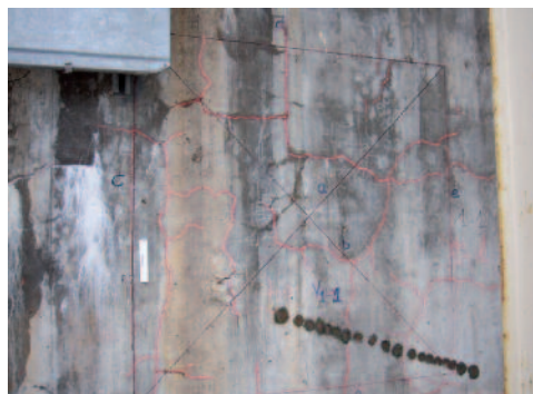
Alcali réaction de béton armé : fissuration et auscultation sonique
