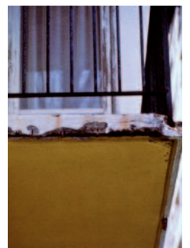
Altération et corrosion du BA de balcons
