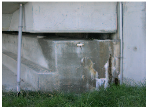
Fissuration de chevêtre par réaction sulfatique interne
