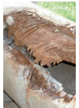
Corrosion de tuyau
