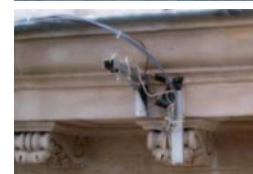
Suivi de fissures et de déformation
